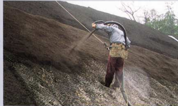
パーク推肥・ビートモスなど有機物が基材のベース。過栄養・保水力不足・撥水などにより、樹林化には不向きな工法。有機物基盤の中でしか根は伸長しない。
