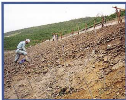
② アンカーピンの打設 (岩盤の場合は削孔作業が必要です。)
