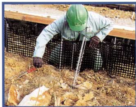
③ 下段よりジオ ウェーブをピンに連結しながら展開、上段へ繰り返し施工
